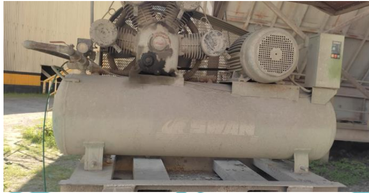
Gambar 1.2 Kompresor bottom silo ash
