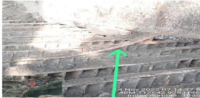
Gambar 1. 1 Kerusakan Pada Grizzly Bar
