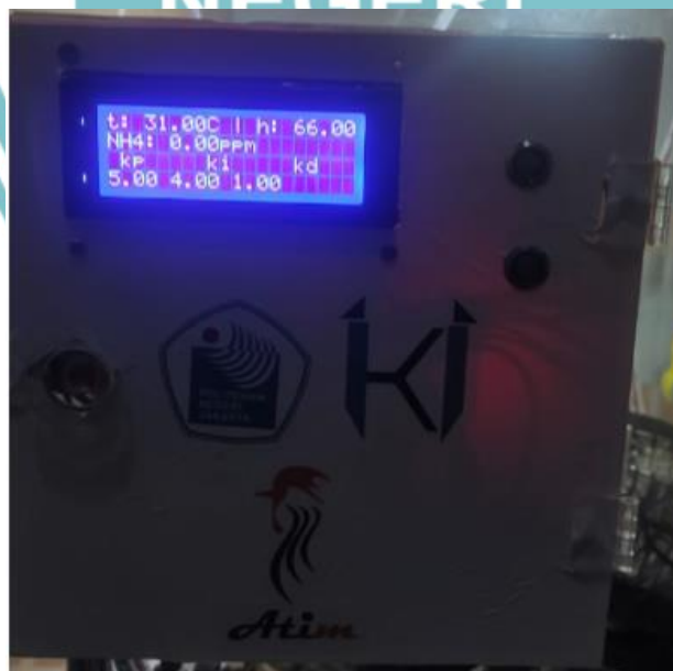
Gambar 3.10 – Panel box sistem kontrol Sumber: dokumentasi pribadi
