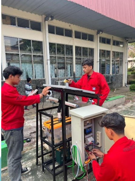
Pengukuran Tegangan Pada PLTS, Intensitas dan Suhu Permukaan Panel Surya
