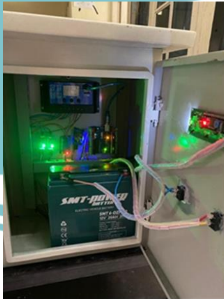
Gambar L- Foto Tampak Dalam Panel Box
