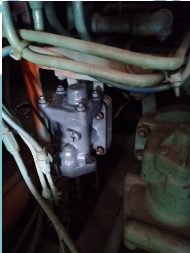
→ Valve P2A, katup yang fungsinya untuk mengontrol pengereman.
