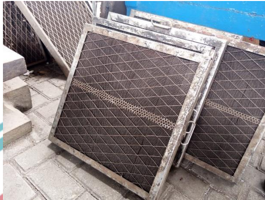
→ Filter udara ruang generator yang berjumlah 14 buah.
