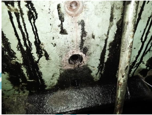
→Rumah baut tempat rembes oli
