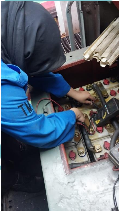
Pengecekan tegangan baterai
