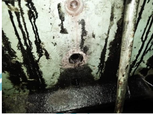
→Rumah baut tempat rembes oli
