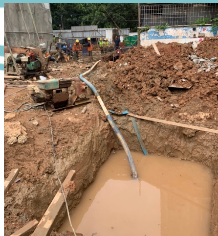
Gambar 4. 10 Sampit Bor Pile (Sumber : Dokumentasi Pribadi)
