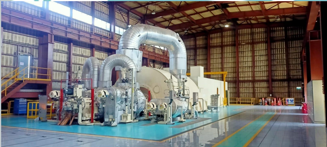
Gambar 3.7 Turbin Uap Blok 2
