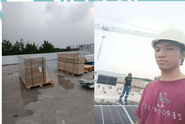
Instalasi PLTS On-Grid dan Off-Grid di Gedung Laboratorium Terpadu Politeknik Negeri Jakarta
