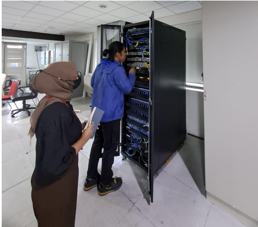
Melakukan Kunjungan Data Center
