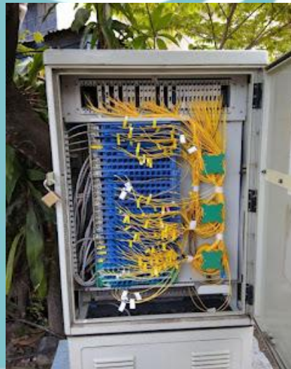
Gambar 2. 3 Optical Distribution Cabinet (ODC)
