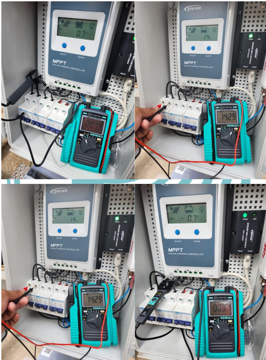
Pengujian Perbandingan Pengukuran SCC dengan Multimeter
