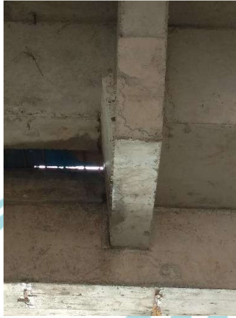
Gambar.0.1.1 Beton Tidak Rata (Plin) Sumber : Data Proyek
