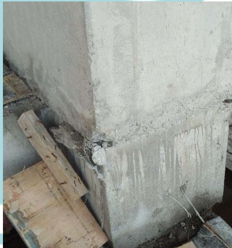
Gambar 1.0.2 Beton Keropos Sumber : Data Proyek
